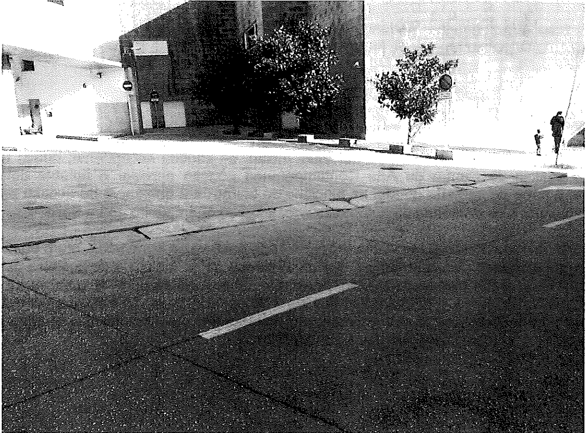
O tramo da rúa Ramón del Valle Inclán deteriorada e o detalle do afundimento das pezas de cantería na súa marxe
